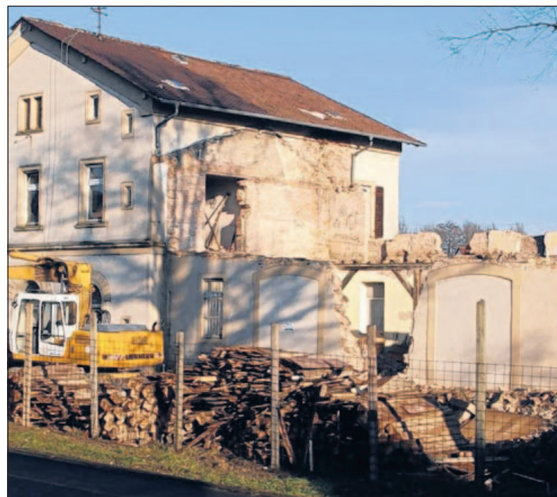
Am alten Bahnhof steht der Abrissbagger. Nachdem zwei von Besitzer Hermann Flick geplante Projekte dort scheiterten, hüllt er sich nun in Schweigen. FOTO: THÜRING
