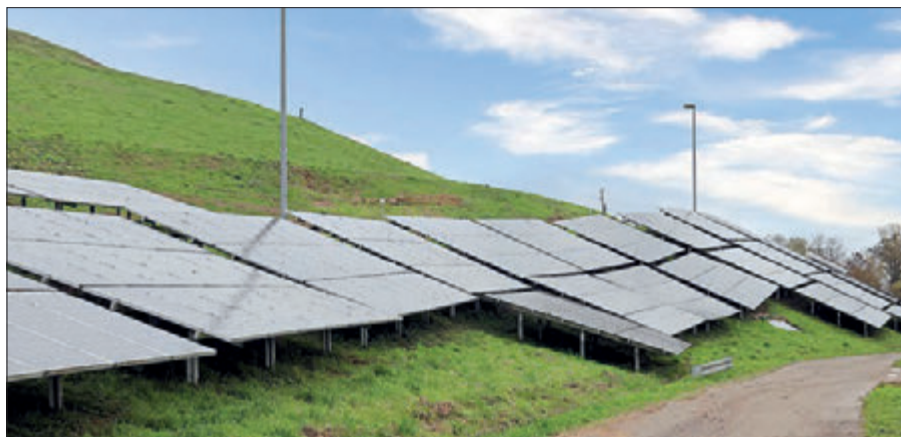
Photovoltaik-Anlagen auf dem Wertstoffhof Berg. Auf dem Wertstoffhof in Westheim sind auf einer Fläche von rund 1.300 Quadratmetern Photovoltaik-Module geplant. Foto: KV GER, Norman Krauß
