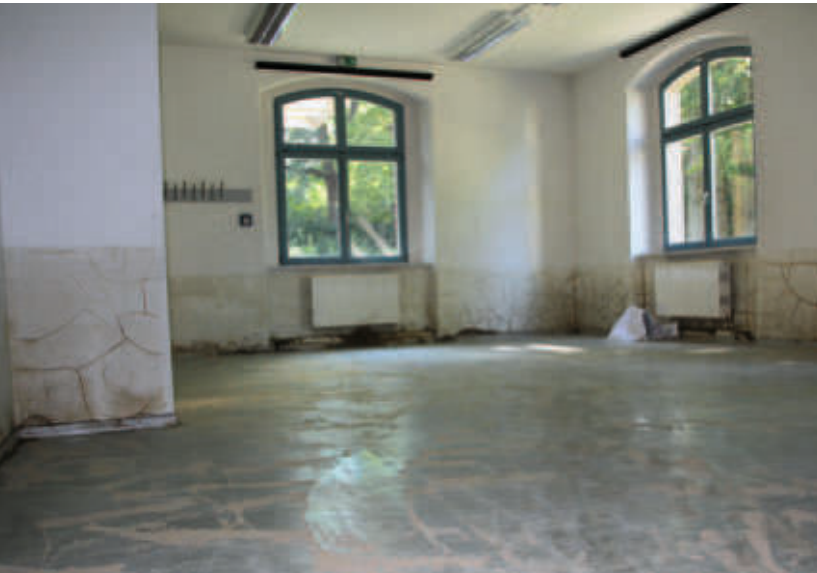
Durchfeuchtete und verschmutzte Außenwände nach Überflutung
