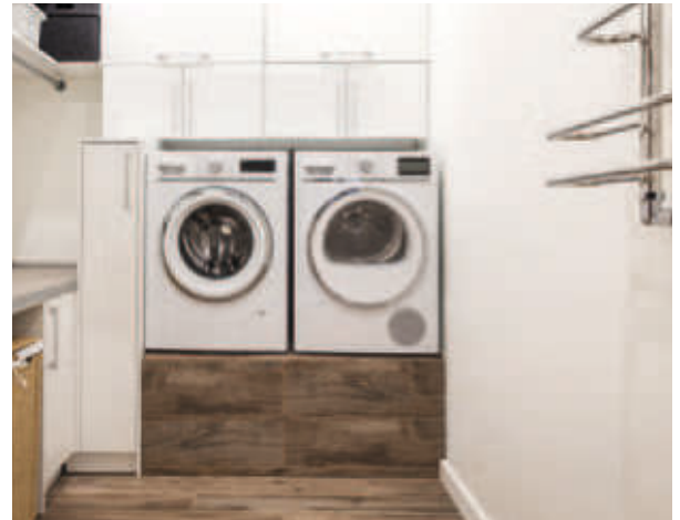
Waschmaschine und Trockner auf einem Podest
