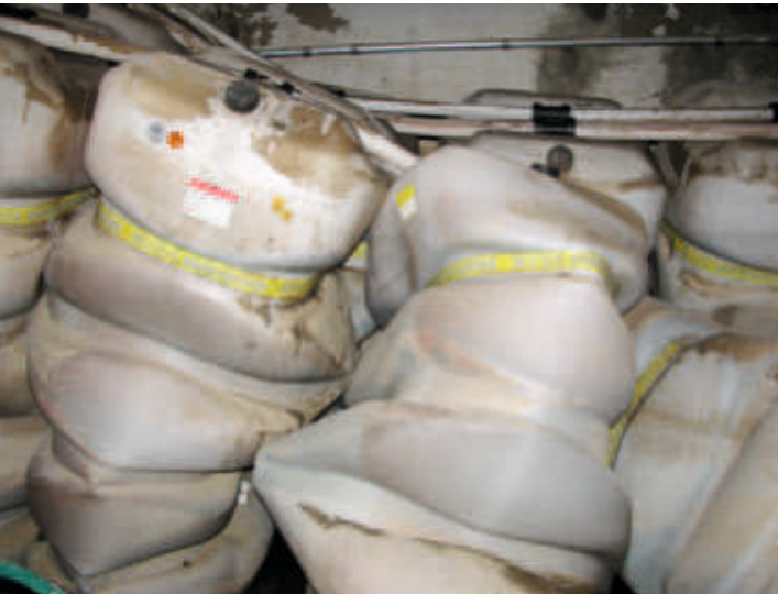
Zerstörte Heizöltanks infolge einer Hochwassereinwirkung
