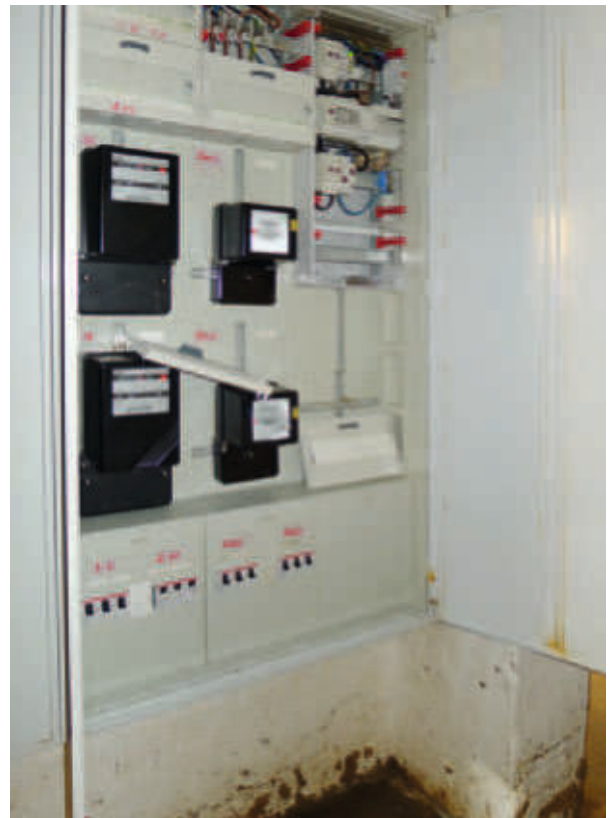
Überfluteter Sicherungskasten in einer Erdgeschosswohnung
