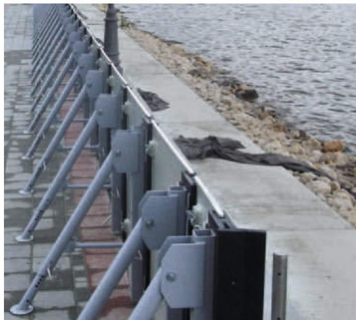
Hochwasserschutz mit Hochwasserschutzplatten aus Kunststoff
