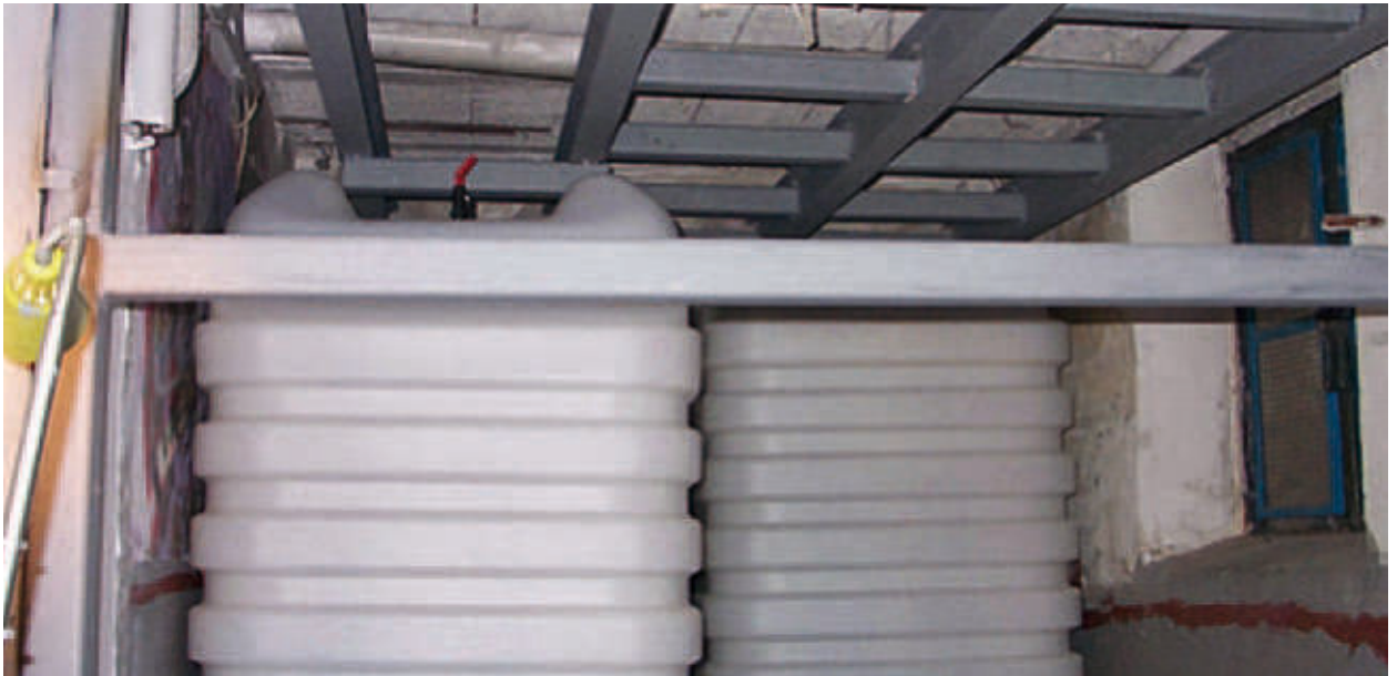
Heizöltankanlage mit Auftriebssicherung
