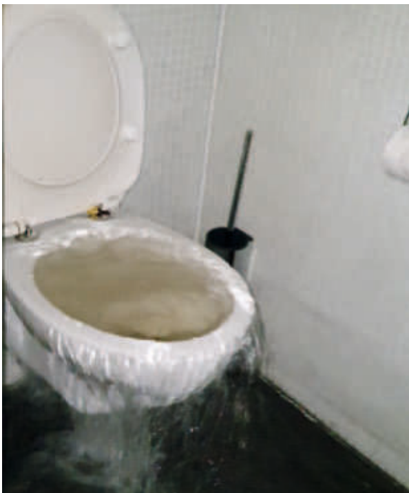
Sanitärgegenstände sollten nach einem Überflutungsereignis aus hygienischen Gründen ausgetauscht werden.
