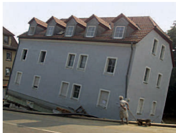
Unterspültes Haus an der Weißeritz
