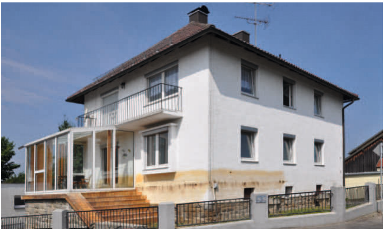
Mit Heizöl belastetes Wärmedämm-Verbundsystem eines Wohnhauses
